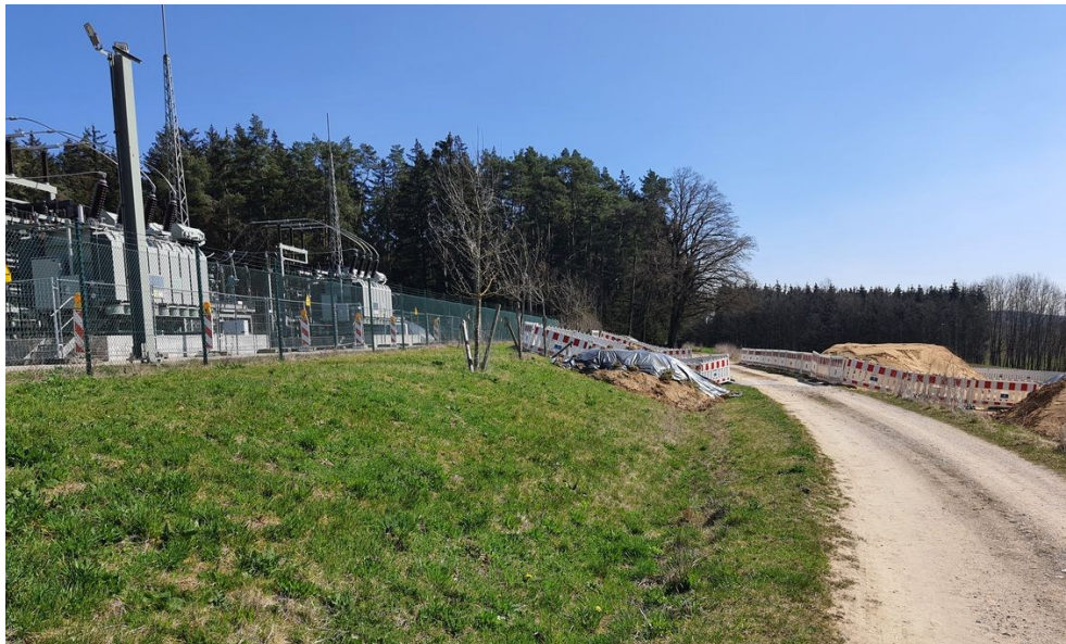
Foto 3: Blick nach Osten, vorhandenes Um- spannwerk
