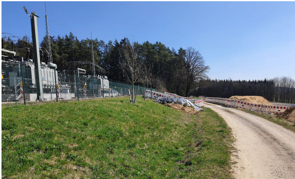
Foto 3: Blick nach Osten, vorhandenes Um- spannwerk
