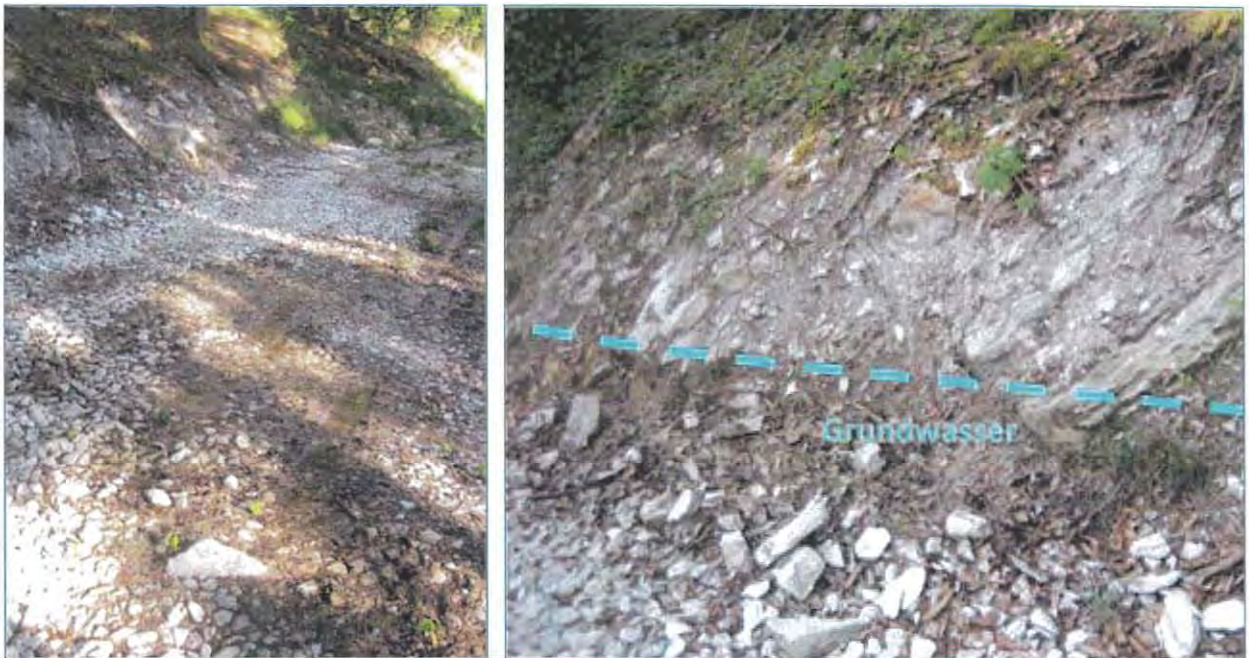
Abb. 3: Beispiel einer Freilegung von Grundwasser durch Forstwegeneubau mit nachfolgender Verkeimung einer Quelltrinkwasserversorgung (Fränkische Alb, Foto: LfU).
